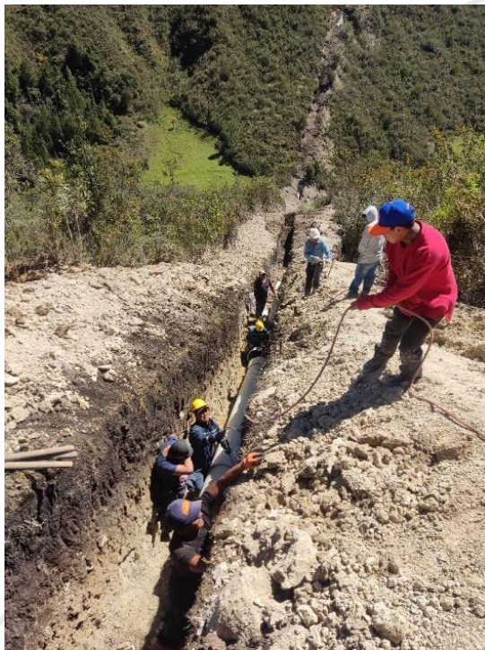
ILUSTRACIÓN 2. SISTEMA DE RIEGO HORNILLOS II – NABÓN, NABÓN.
