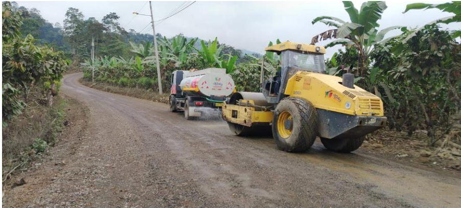
Gráfico 11 MANTENIMIENTO VIAL EN EL TRAMO TAMARINDO – ESTERO PIEDRAS, PARROQUIA MOLLETURO, CANTÓN CUENCA - IYS101
