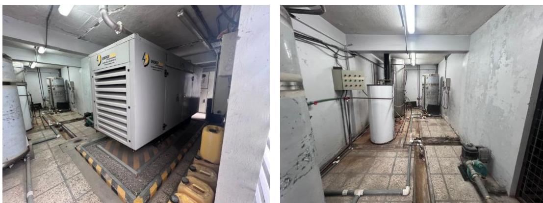
Fotografía 30. Área del generador eléctrico (E1, P1).
