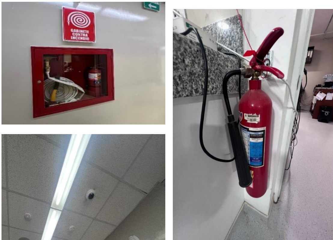
Fotografía 33. Sistema contra incendios. Fuente: Equipo Consultor, 2025.
